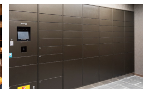
宅配ボックス
