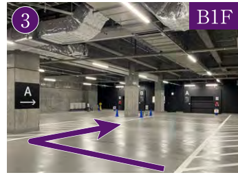
機械式駐車場に入庫。
